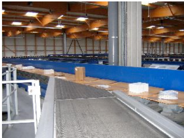
Figura 36 – Esteira de entrada do anel principal
